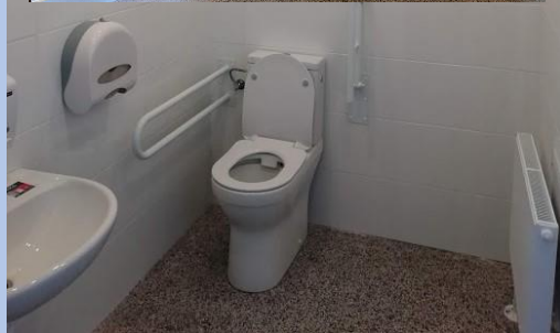
Bezbariérové WC a plošina pro vozíčkáře
